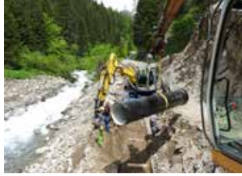
Condotte a turbine
