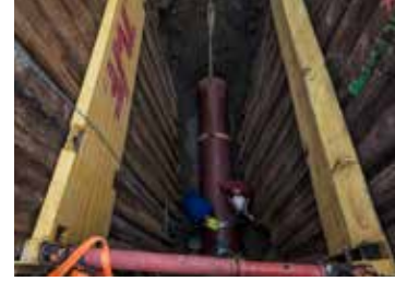
Smaltimento delle acque reflue
