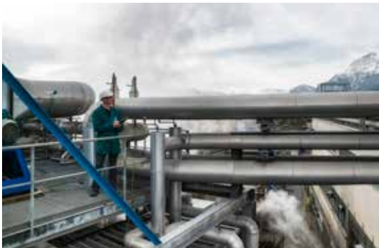
Trattamento dell'aria di scarico e delle acque reflue
