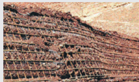
Minima estrusione della facciata di valle del rilevato.
