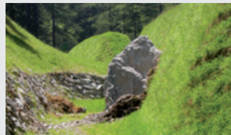
Masso roccioso fermato da paramassi in terra rinforzata in località Créton nel Comune di Rhêmes Saint-Georges (AO).
