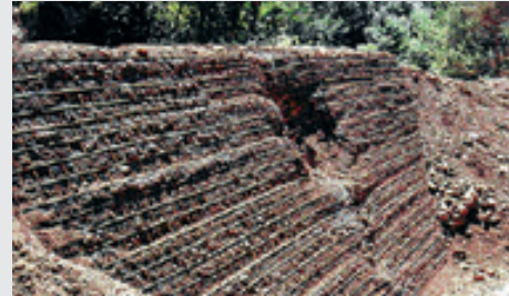
Il vallo paramassi in terra rinforzata, a seguito dell'urto, è danneggiato ma integro.
